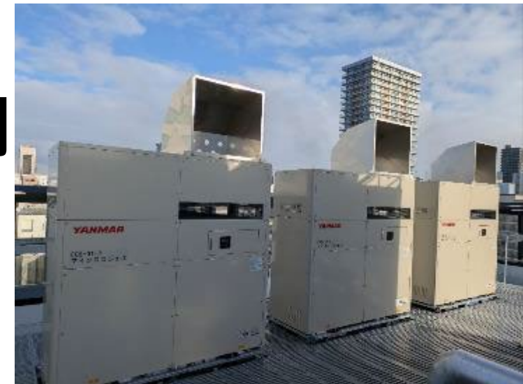
▲コージェネレーションシステム設備
