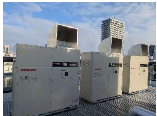
▲コジェネレーションシステム設備
