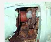
腐食したポンプ設備
