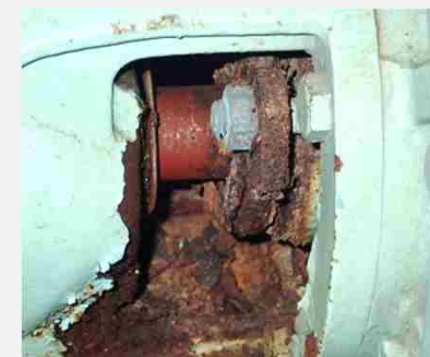
腐食したポンプ設備
