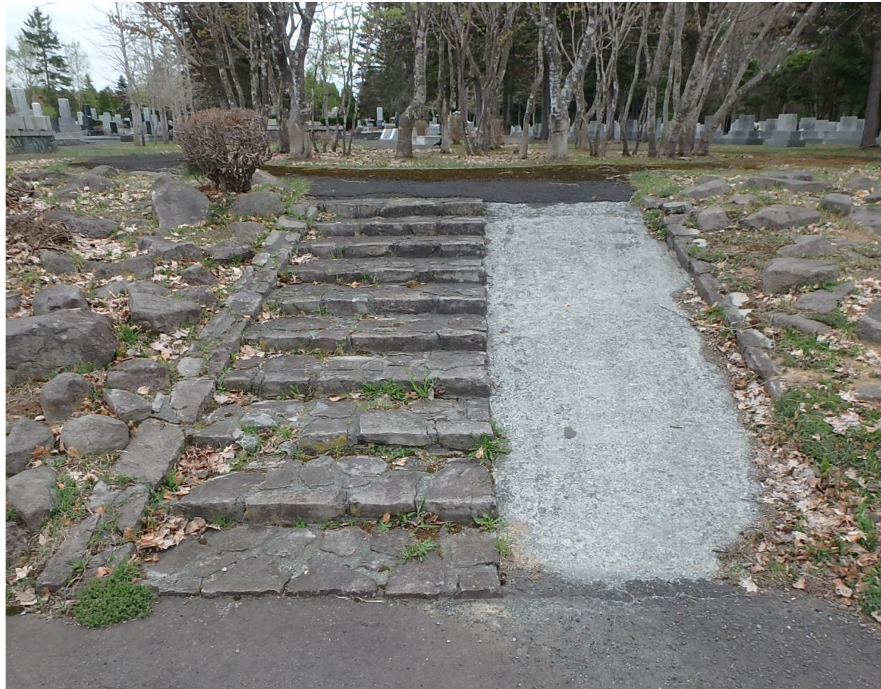
▲手すりのない階段
