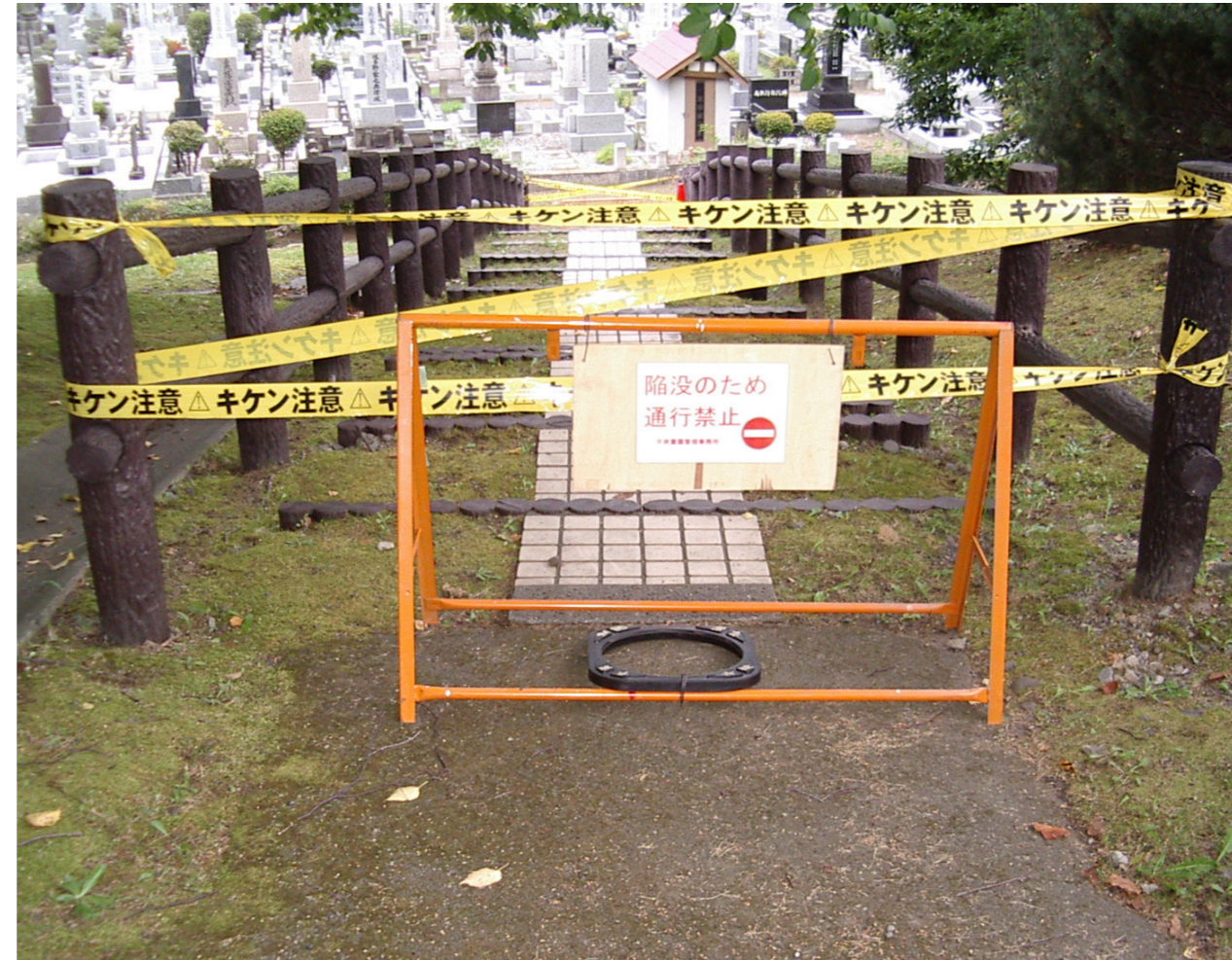
▲老朽化した階段
