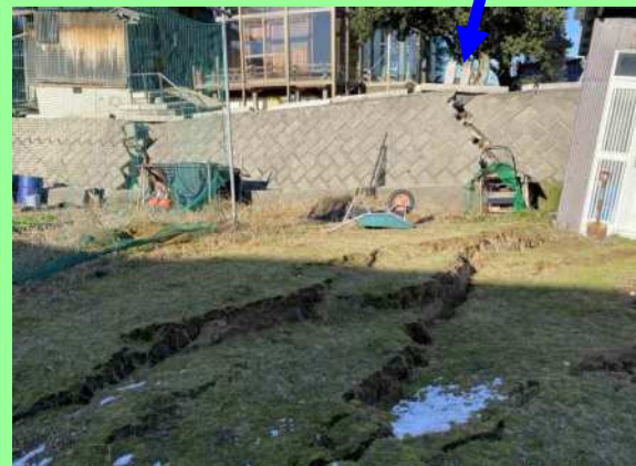
頭部の地割れ
