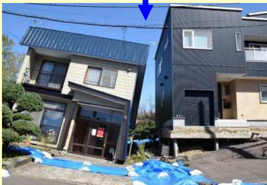
頭部の地盤沈下
