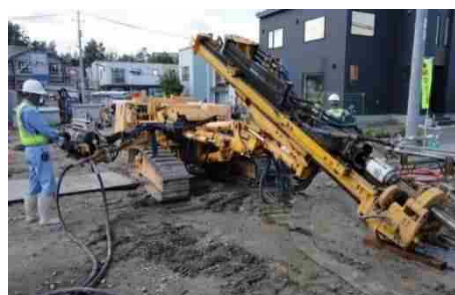
平成 30 年北海道胆振東部地震での道路や宅地の復旧
