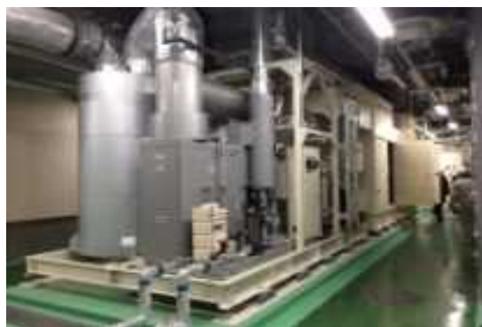
コージェネレーションシステムの整備事例 (創世エネルギーセンター)
