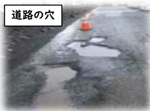
道路のひび割れ
