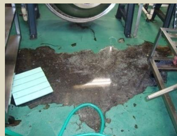
築34年 塗床の剥離
