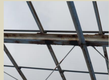
築20年 プール上屋の鉄骨にさびが発生
