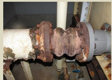
築32年 給水設備の老朽化
