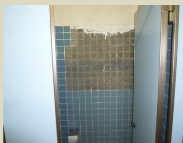
築43年 トイレの内部のタイルが剥落
