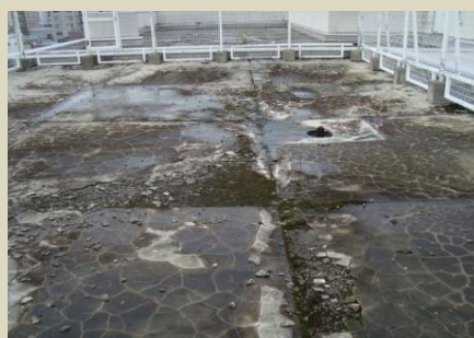
築27年 屋上コンクリートの劣化
