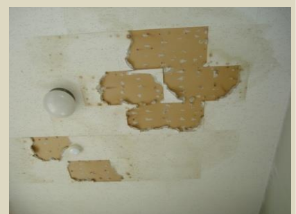
築41年 漏水による天井材の劣化
