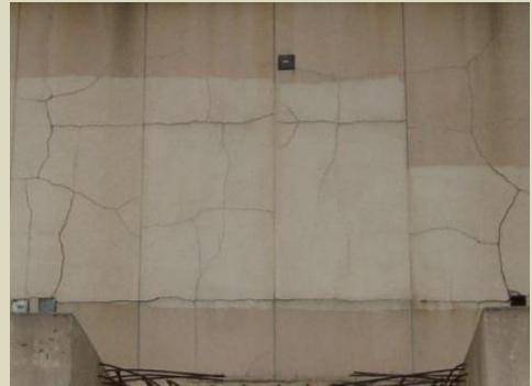
築30年 外壁のひび割れが発生
