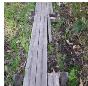
破損した木道(自然歩道)
