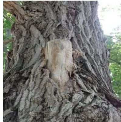
【西側】上部剪定痕からの腐朽
