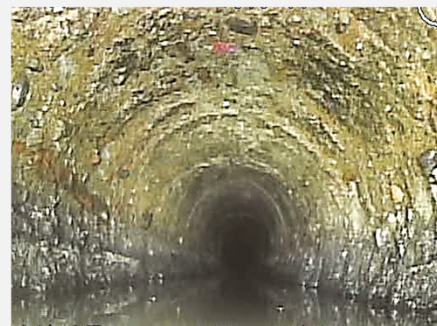
老朽化した管路
