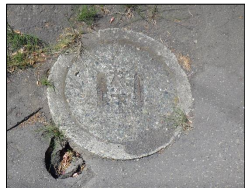
【取付管に起因する道路陥没事例】
