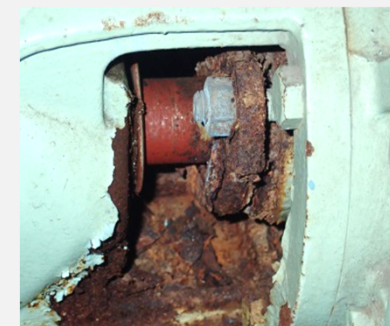
腐食したポンプ設備
