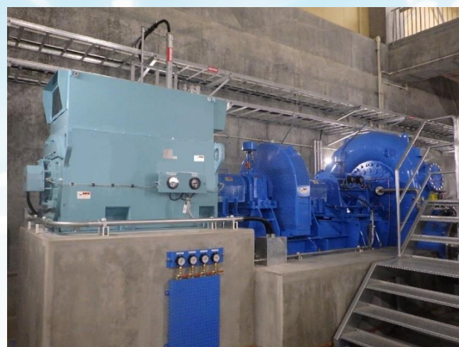
平岸配水池の水力発電設備
