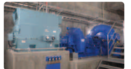
平岸配水池の水力発電設備
