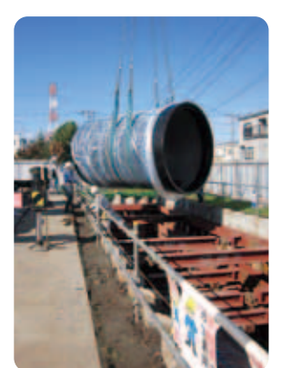
緊急貯水槽設置のようす
