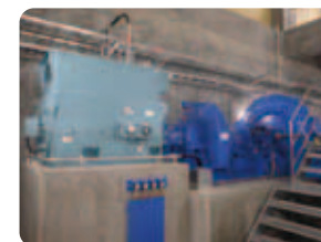
平岸配水池の水力発電設備
