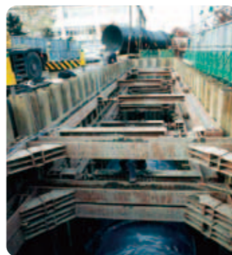
緊急貯水槽の設置【昭和62(1987)年~】
