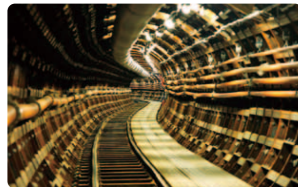
白川第3送水管布設工事(管を布設する際のトンネル内部)【平成15(2003)~令和元(2019)年】
